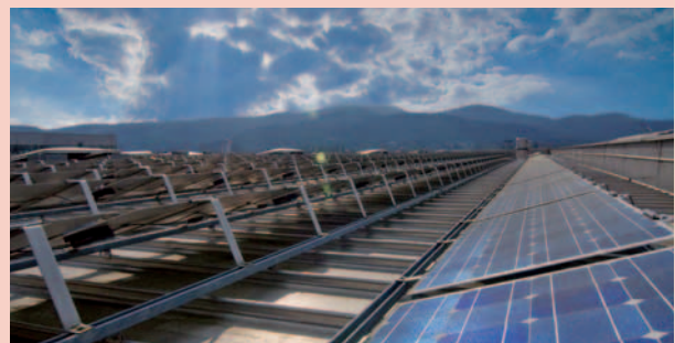
Unter freiem Himmel: Photovoltaik-Kraftwerk.
