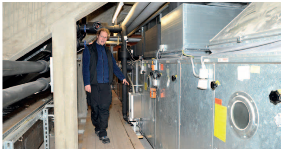
Die Lüftungsanlage, die dafür sorgt, dass die Rechner "cool" bleiben.
